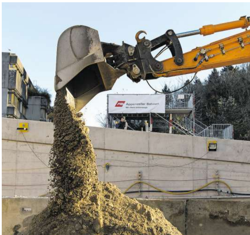
Grossbaustelle mit Deponieproblem: Der Aushub des Ruckhaldetunnels der Appenzeller Bahnen in St. Gallen ging 2016 grösstenteils in Ausland. Bild: Keystone
